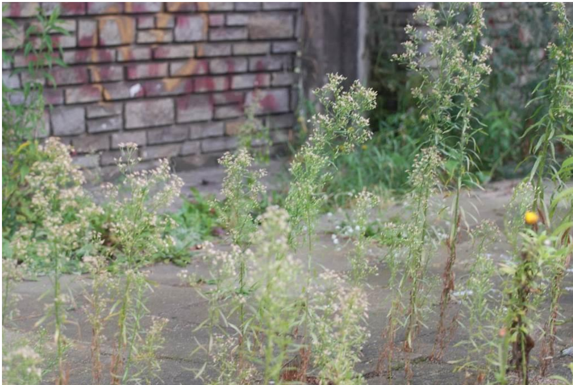
Fot. Konyza kanadyjska rosnąca pomiędzy betonowymi płytami rampy kolejowej
